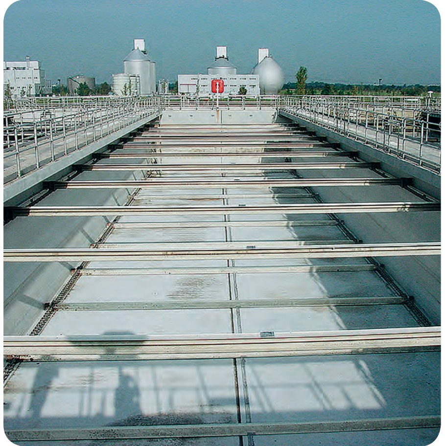
Boden- und Schwimmschlammräumer
