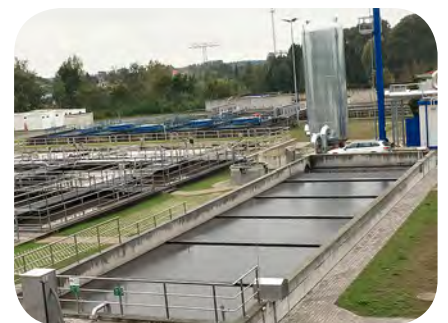
Kommunale Kläranlage mit Kettenräumer
