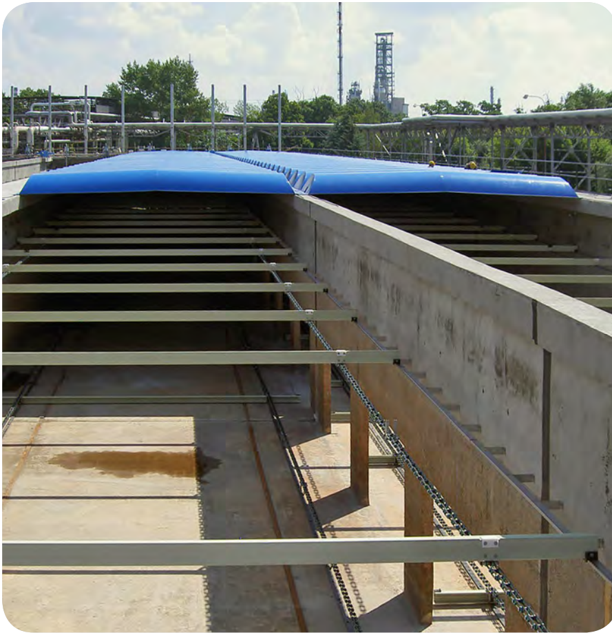
GFK-Abdeckung für API Becken
