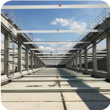
Boden- und Schwimm Schlammräumer
