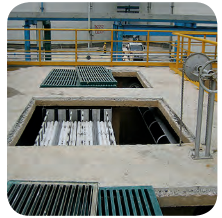
CPI-Einbauten mit Abdeckung
