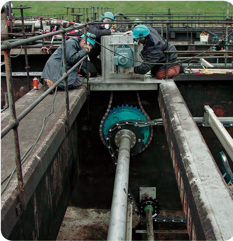
API-Absetzbecken in der Raffinerie
