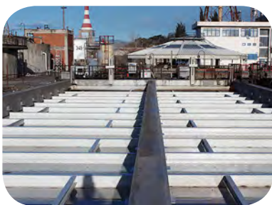
API-Becken mit schwimmender GKF-Abdeckung
