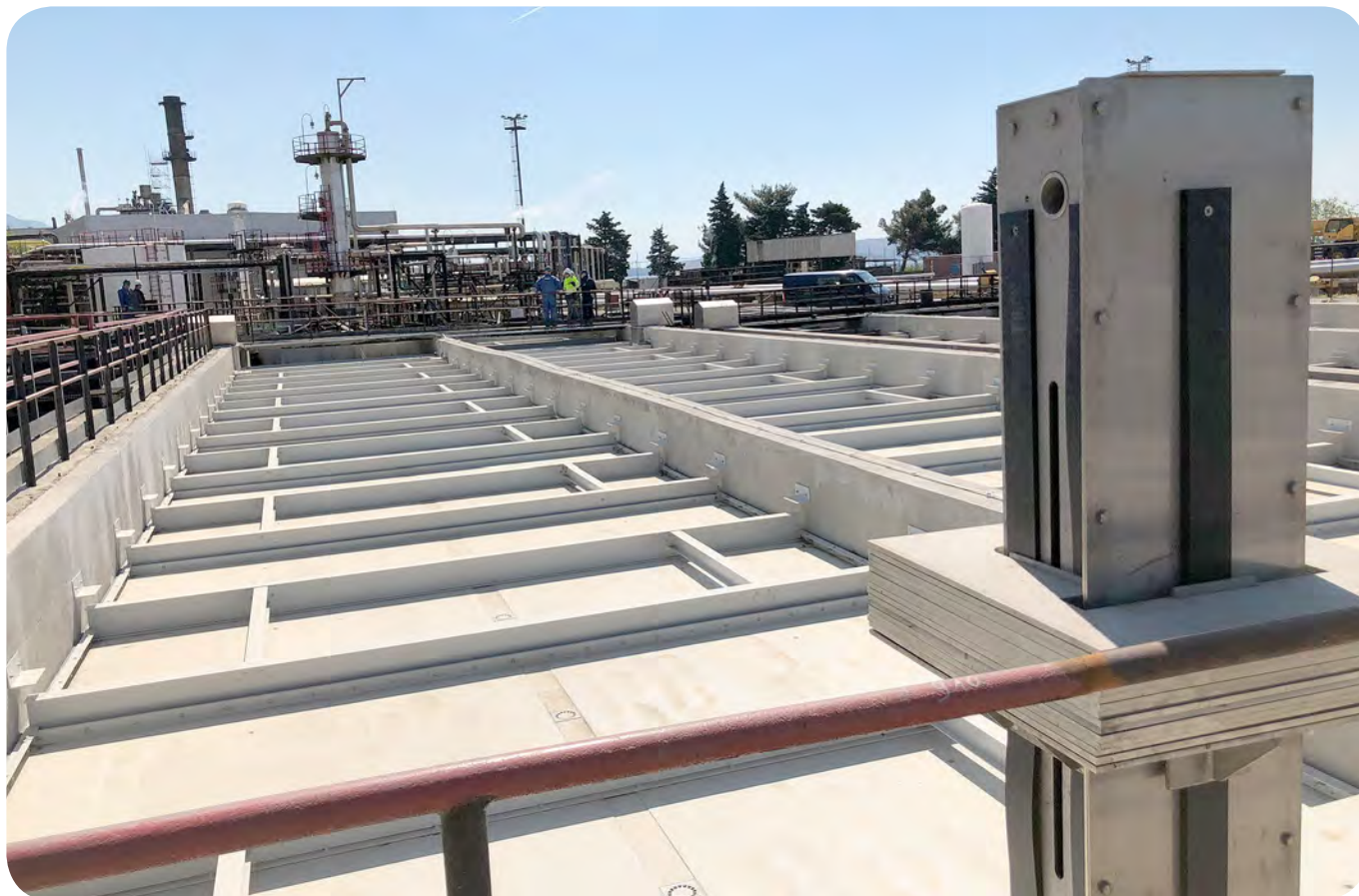
API-Becken mit schwimmender GFK-Abdeckung
